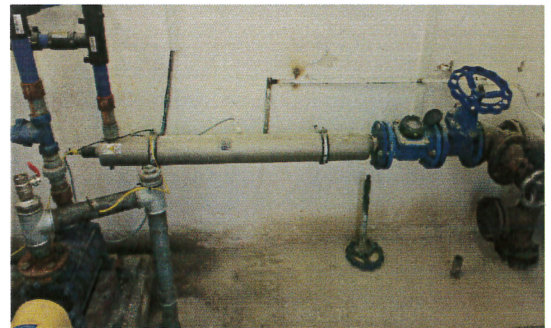
ujęcie Grębyńnice – system dezynfekcji promieniami UV
